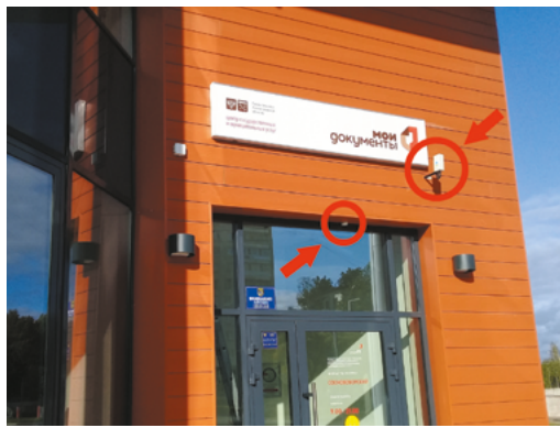
Рисунок 3. Радиотрансивер и звуковой маяк, установленные над входом в здание
